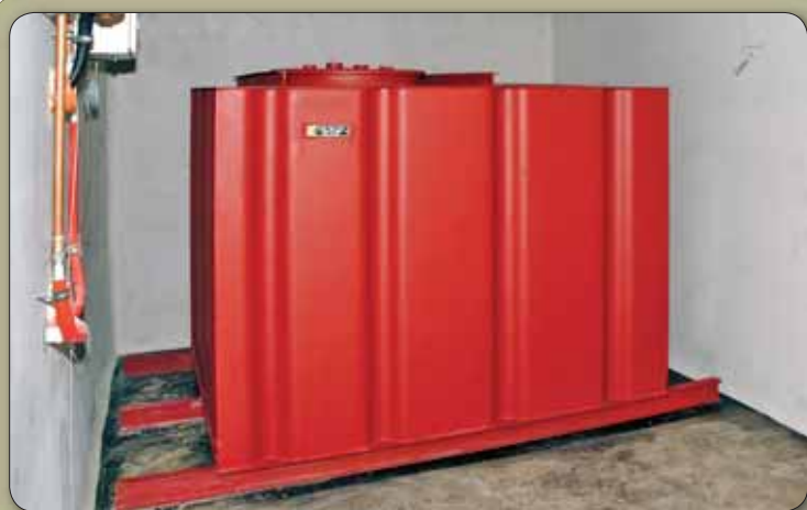
Neuer standortgefertigter Stahltank nach DIN 6625 (Außenansicht)
