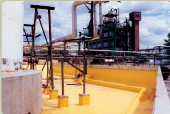
WHG-Abdichtung in einem Auffangraum für Flachbodentanks
